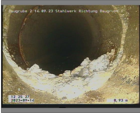
Entfernen von eingedrungenem Beton bei Muffen
